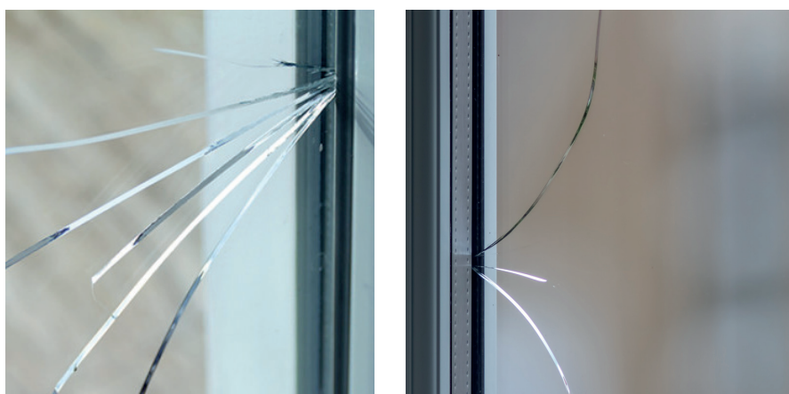
Fissure vitrage choc thermique
